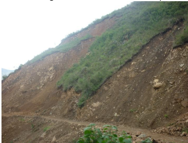
Deslizamientos traslacionales causados por el corte de la carretera, en el distrito de Kañaris.
