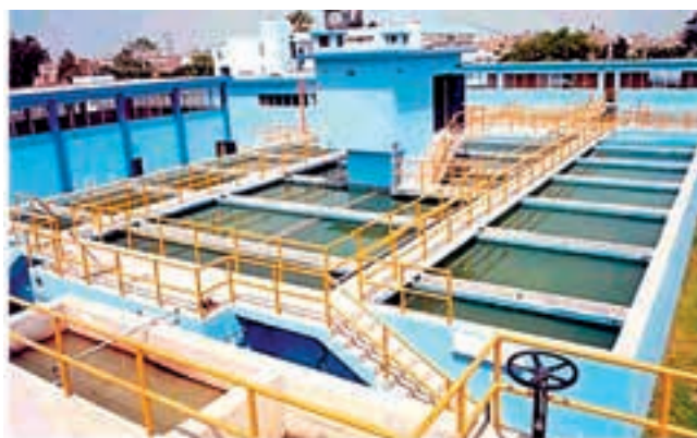
Foto N° 22: Planta de tratamiento de agua - EPSEL
